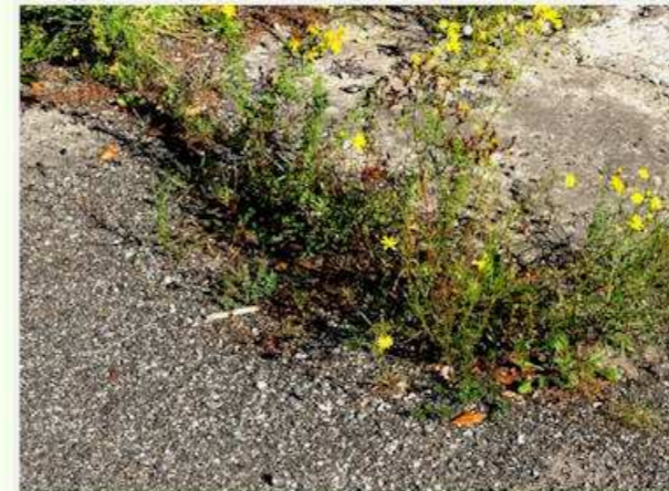
Das Greiskraut bahnt sich durch Spalten und Fugen seinen Weg.
